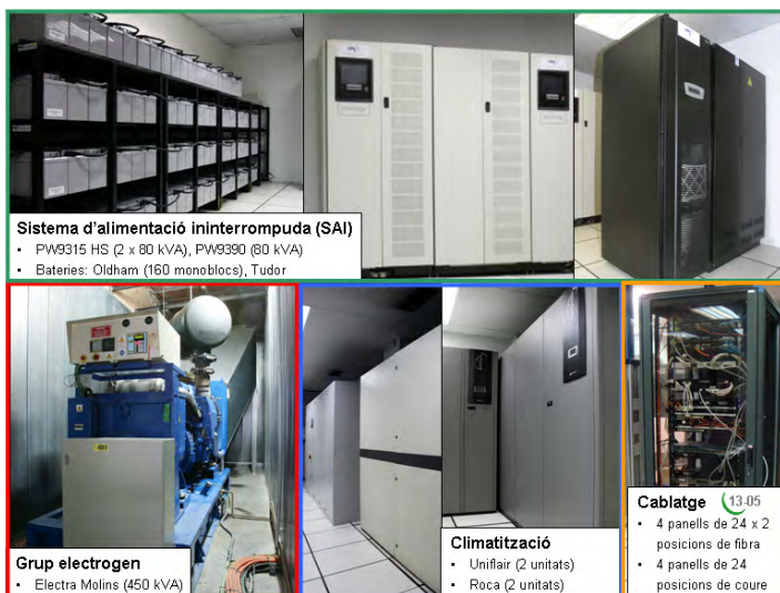
Figura 22. Les instal·lacions tècniques a l'Edifici Annex
