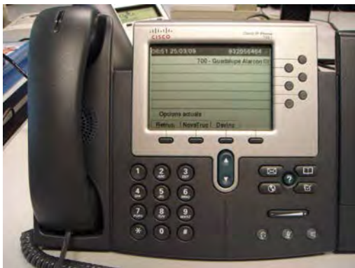
Figura 24. Equipament de ToIP
